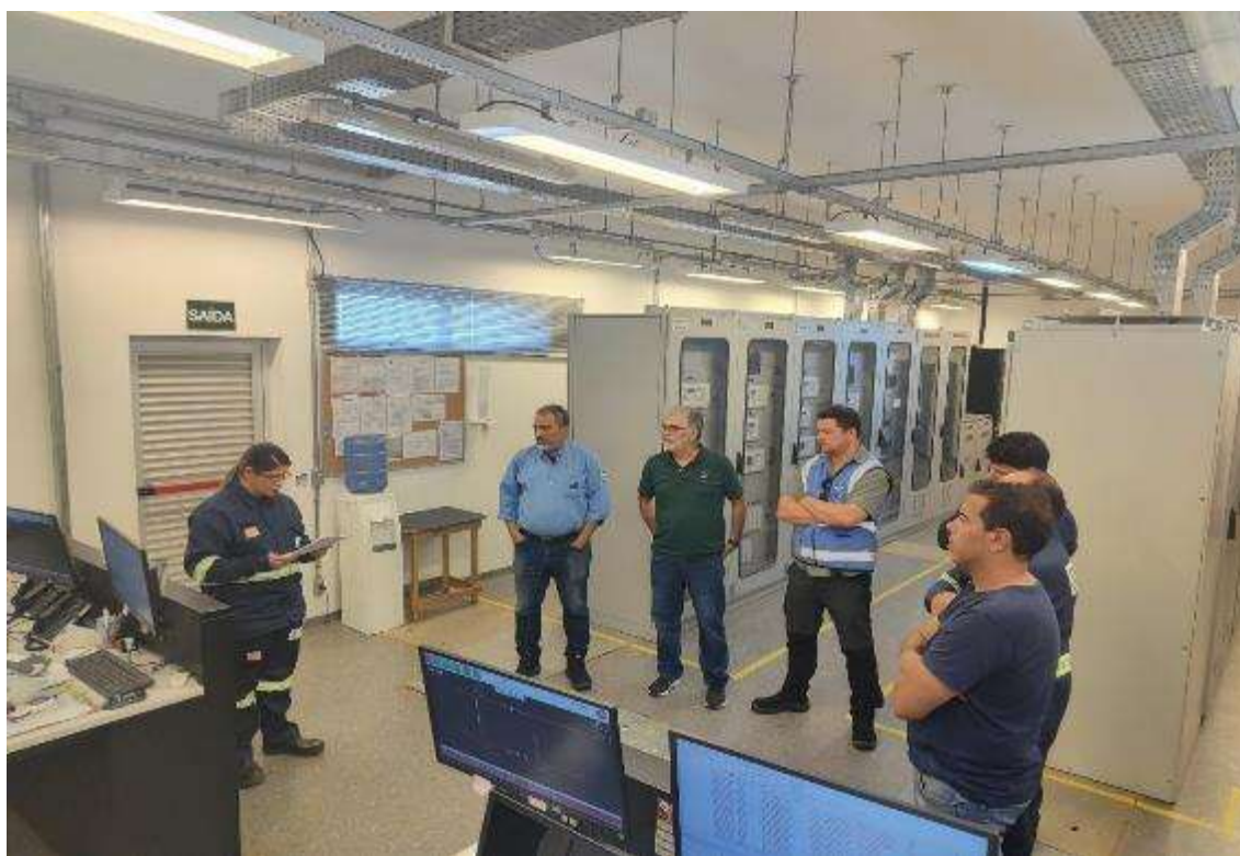
Foto 08: Vistoria do IBAMA realizada na LT SP-MG em setembro de 2024.
